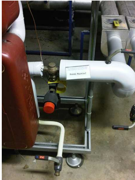
Foto 3 Teil der Trinkwassererwärmung (Wärmetauscher) mit Rücklauf
