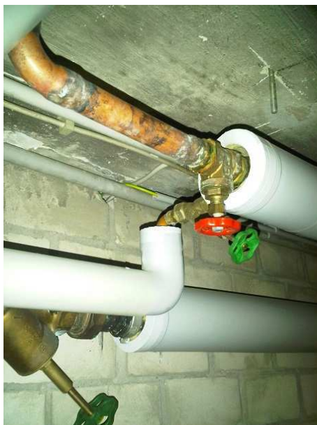
Foto 5 Als Rohrleitungsmaterial wurden augenscheinlich Kupferleitungen verwendet.
